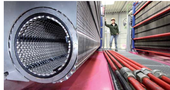
Plattenwärmetauscher im Geothermiekraftwerk Bruchsal
