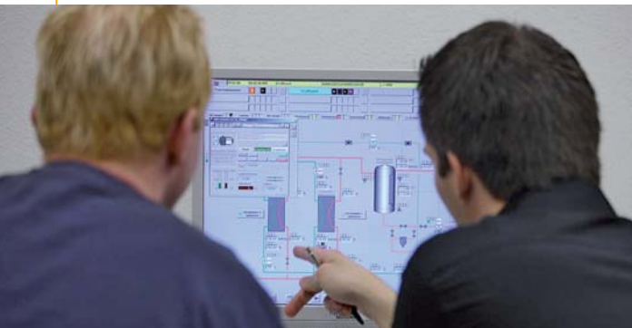
Zentrale Leittechnik für die Kraftwerkssteuerung
